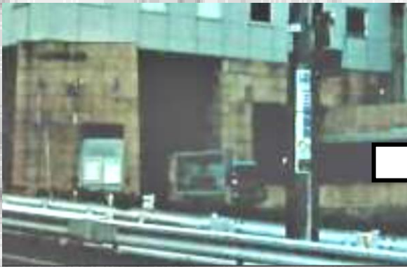
洗浄+保護処理前 (1999年撮影) 1995年~1999年の約5年間の汚れと蘚苔類の繁殖による黒染みがかなり進んでいる。
